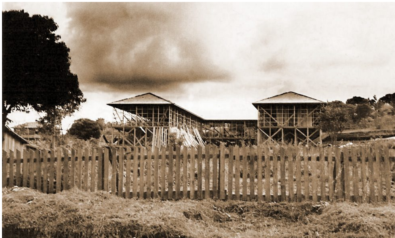
Construção do Hospital Beneficente São Lourenço – 1962. Mais tarde adquirido pelo Dr. Bruno e denominado Hospital e Maternidade São Lourenço. Aos poucos, sua estrutura foi substituída por alvenaria. Acervo de Bronislau Polan Breowicz
